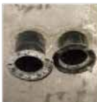
Sleeves stuck in concrete after pour
